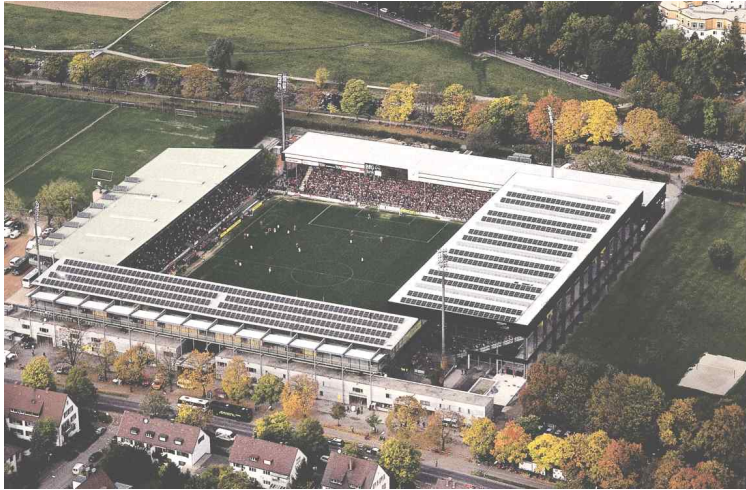
fesa e.V. 1995 / Südtribüne SC Freiburg 93,6 kWp → ca. 90.000 kWh/a 158 Beteiligte
