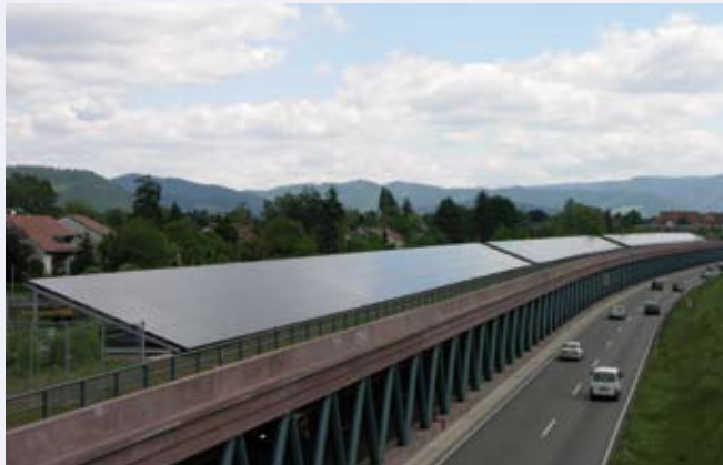
fesa Solaranlage auf der B31
